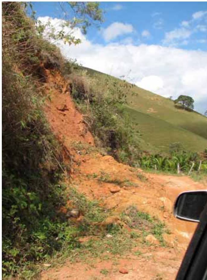
Foto 02 - Movimentação de massa sobre corte de estrada. Estrada local, próxima às margens do rio Grande, na localidade de Pau D'elho. Com face voltada para noroeste, essa morfologia compreendida pelo compartimento Jaqueçaba, apresenta inclinação positiva acentuada favorecendo os processos de movimentação de material à montante.
