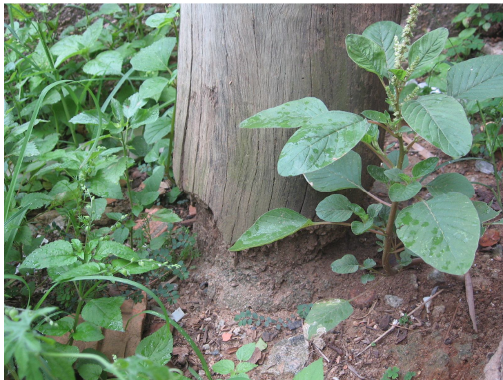
Fotografia 5: da base podre de um poste de madeira no Alto Bairro da Penha.
