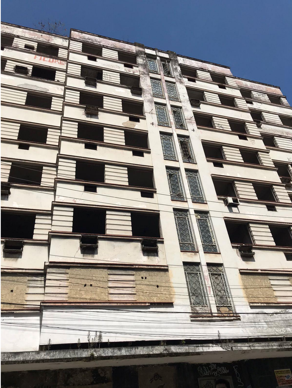
Foto 13: Imóvel na Av. Florentino Ávidos completamente sem uso, sem janelas e com as entradas fechadas com blocos de concreto. Arquivo Pessoal, 2023.
