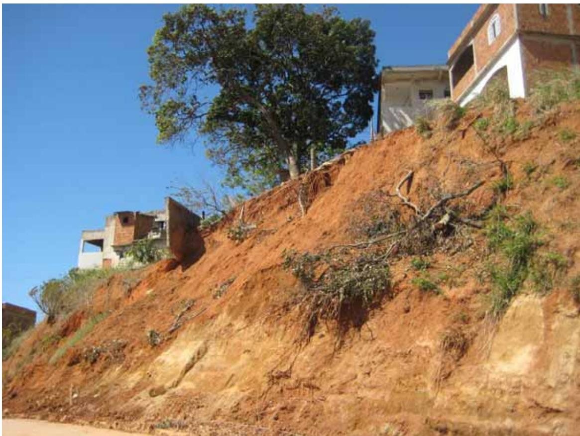
Foto 8: Área de potencial risco de movimento de massa sobre relevo das Colinas Costeiras. Fonte: Autor (2010). Porto de Santana, Cariacica – ES.
